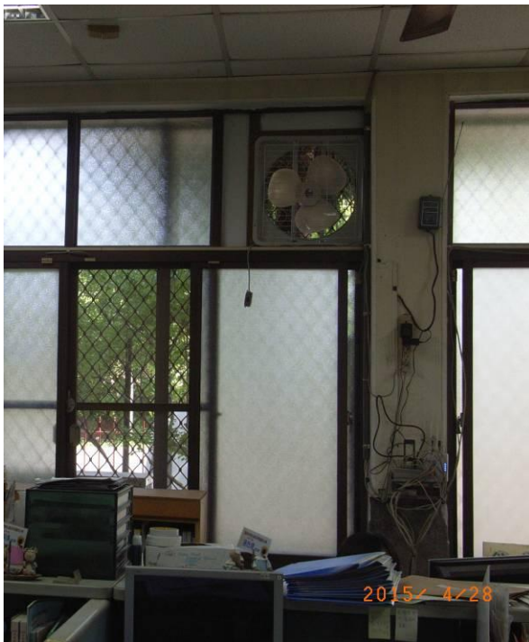
辦公室的排風扇，改善通風狀況，提昇工作效率。
