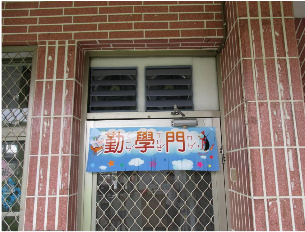
教室的排風扇，讓室內空氣循環更好，通風更順暢。
